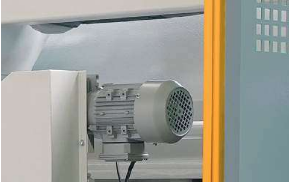
Siemens Main Motor
